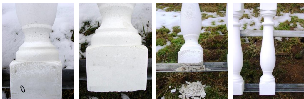
Abb. 1 bis Abb. 4: Einfluss der Massehydrophobierung auf die Dauerhaftigkeit nach 2 Monaten (Abb. 1 und Abb. 2) sowie nach ca. 12 Monaten (Abb. 3 und Abb. 4). Unbehandelt zeigen sich deutliche Schädigungen im Bereich der Einschnürungen und der Säulenfüße (Abb. 1 und Abb. 3).
